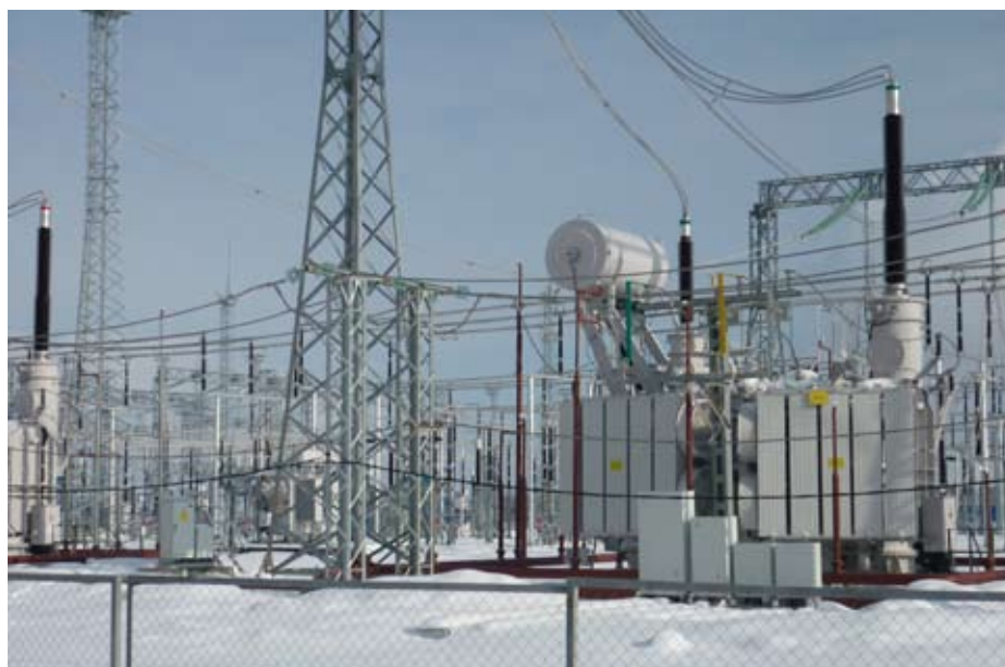
ПС 750 кВ «Грибово»
